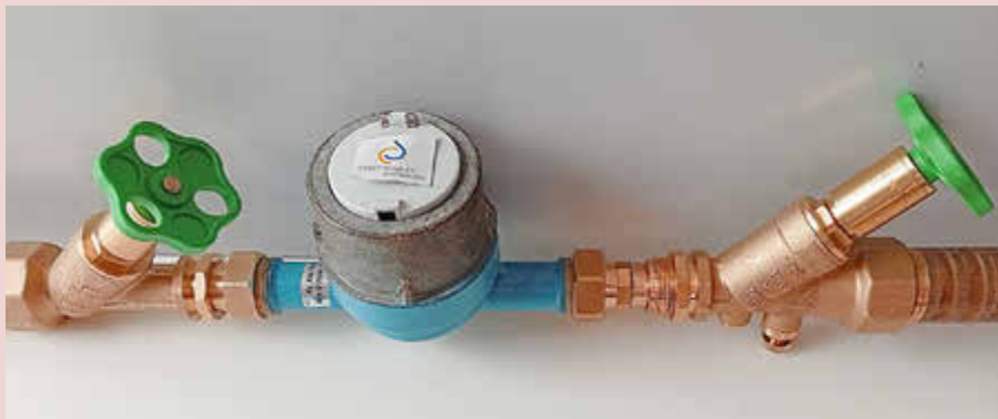
Anlage ohne Wasserzählerbügel
