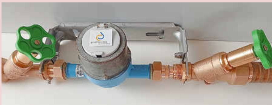
Anlage mit Wasserzählerbügel
