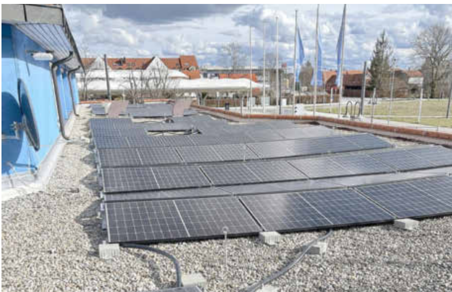
Die Photovoltaik-Anlage, die im vergangenen Jahr auf dem Vordach der Eisarena eingebaut wurde. Foto: Maximilian Semmlinger
