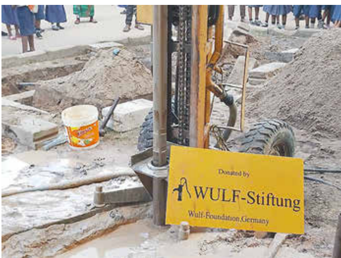
Brunnenanlage mit der Bohrung von der Schule Kibaden in Tansania Foto: Khalid, Leiter der Organisation World of Peace Foundation
