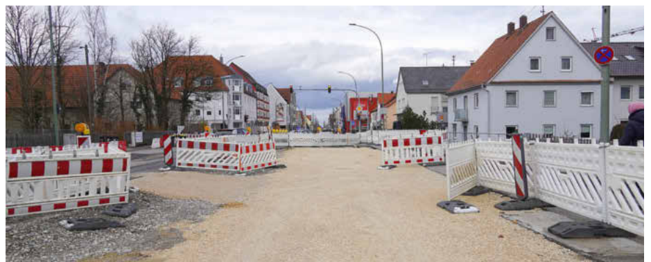
Im südlichen Bauabschnitt werden die Arbeiten auf der Ostseite nach der Winterpause wieder aufgenommen. Fotos: Anke Maresch
