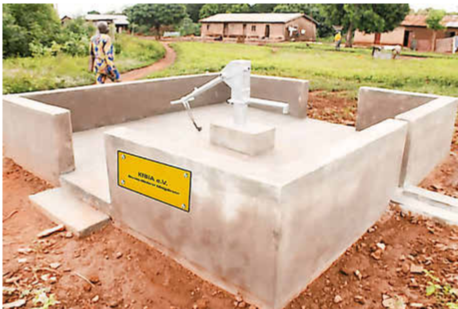
Das Bild zeigt beispielhaft die fertige Brunnenanlage im Dorf NDIGALE.
